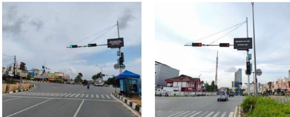
Gambar 3.32. APILL Simpang Panasonic Batam Centre (Pembangunan Tahun 2025)
